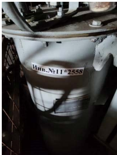
Лот 1 «ПС Промбаза ТСН-3» (силовой трансформатор)
