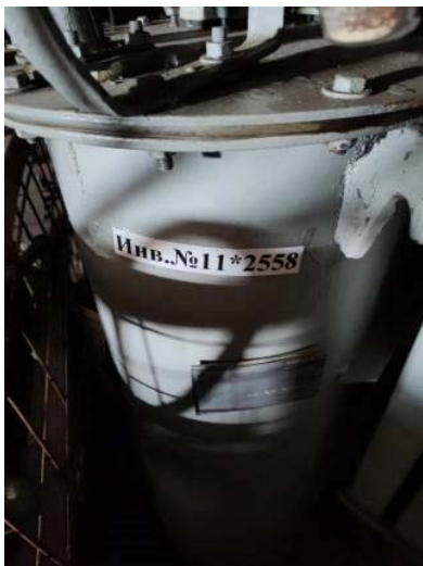
Лот 1 «ПС Промбаза ТСН-3» (силовой трансформатор)
