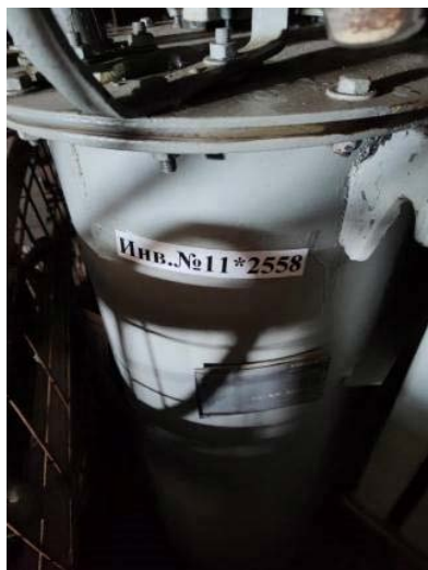
Лот 1 «ПС Промбаза ТСН-3» (силовой трансформатор)
