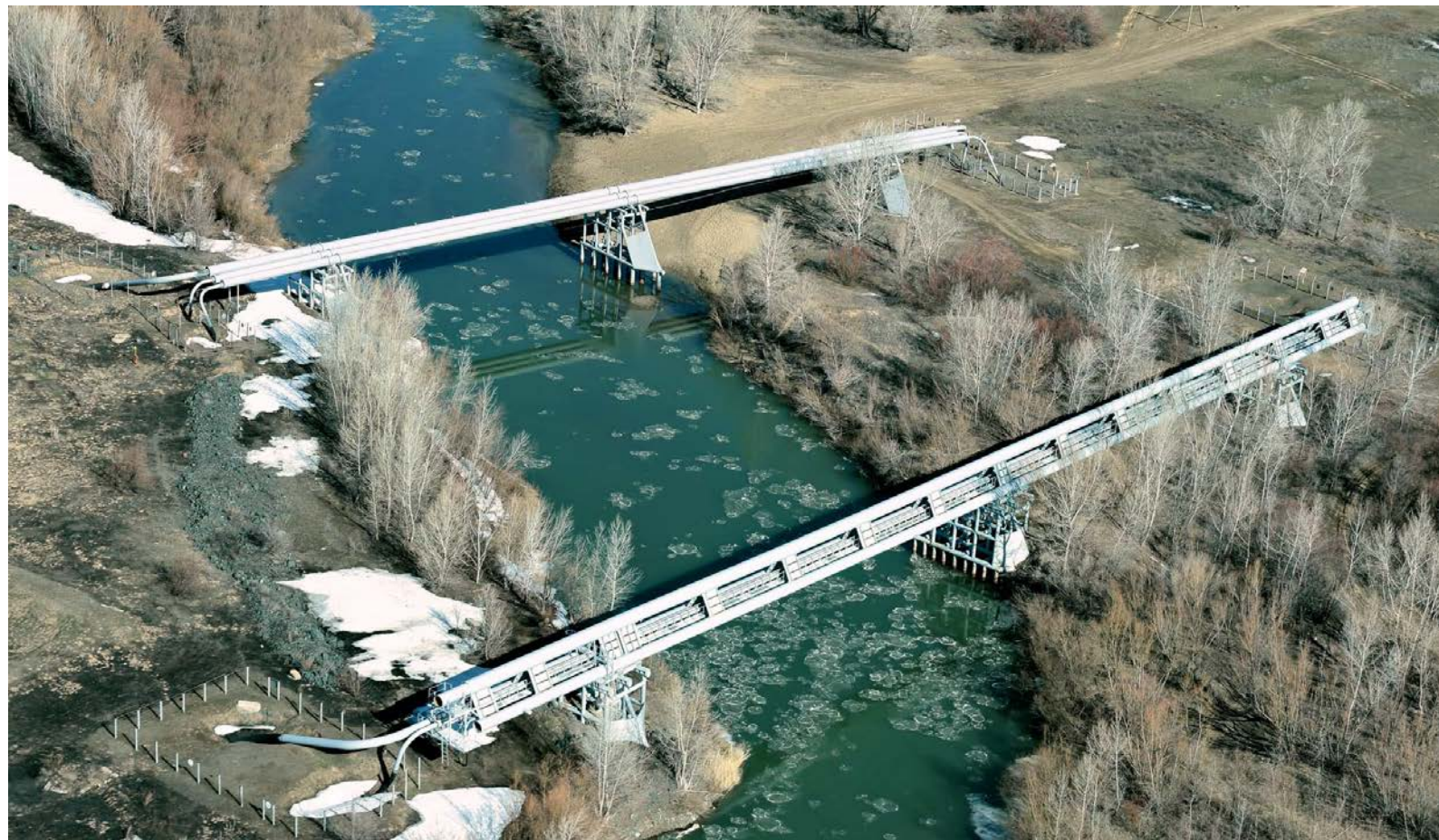
Воздушные переходы газоконденсатопроводов Западного коридора через реку Илек
