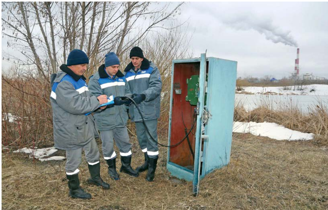
Связисты контролируют уровень давления закачанного воздуха в контейнере необслуживаемого регенерационного пункта, находящегося в пойменной зоне
