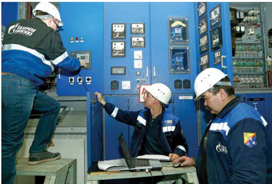
До модернизации высоковольтного щита в каждом его отсеке (справа) размещалось полсотни различных приборов и устройств. Теперь все это оборудование заменил лишь один цифровой терминал с микропроцессором (слева). Специалисты газоперерабатывающего завода ведут его настройку
