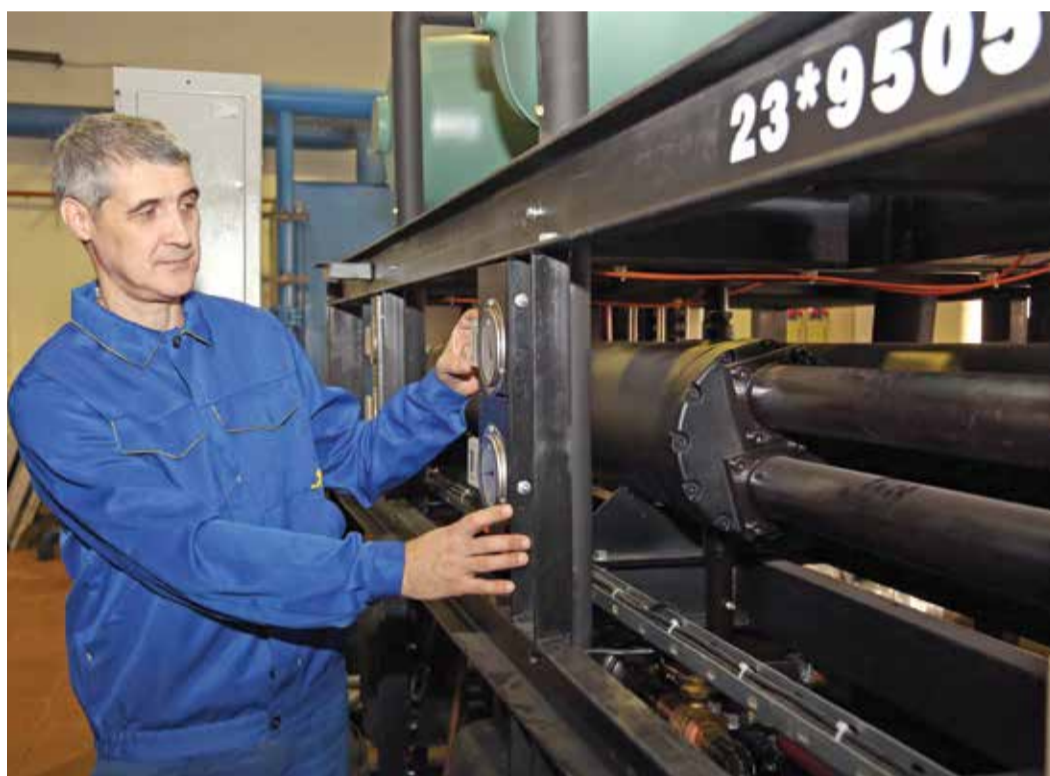
Машинист холодильной станции Ледового дворца Андрей Коломиец контролирует работу новой системы
