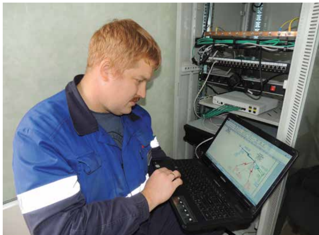
Инженер управления связи Антон Стариков проверяет новую систему
