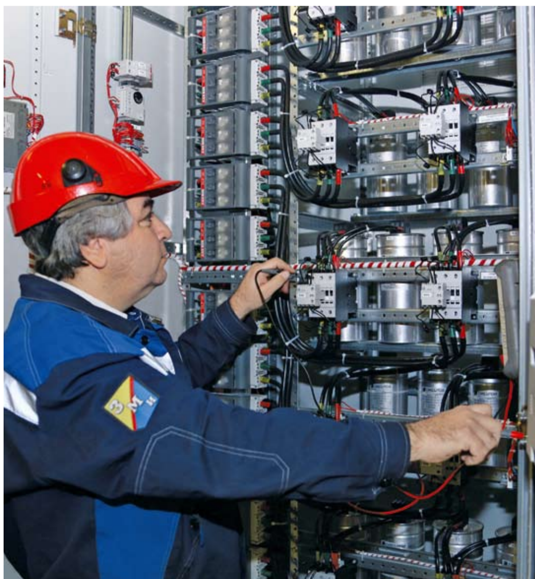
Электромонтер Алексей Бояхчан регулирует параметры конденсаторной установки
