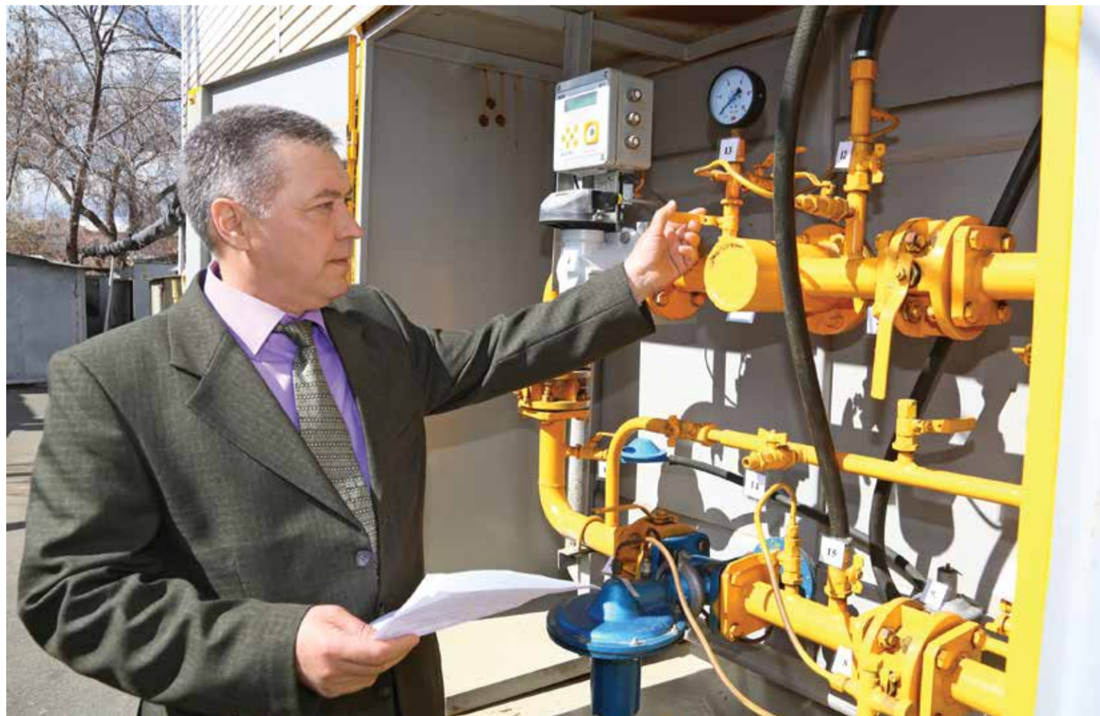
Вячеслав Дегарев знакомится со схемой газораспределительного шкафового пункта перед выполнением практического задания
