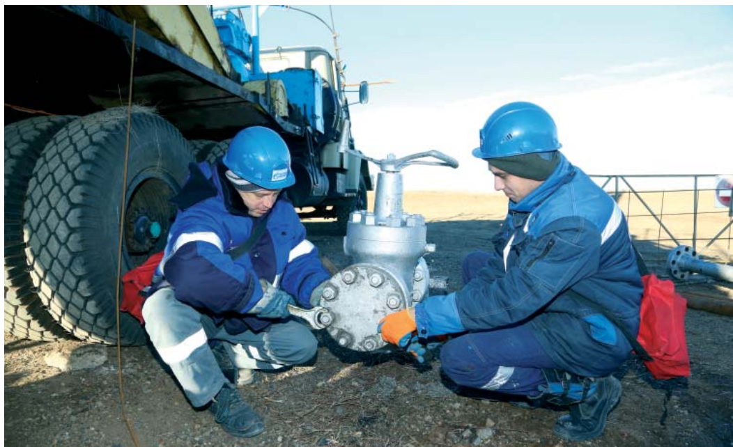
Операторы по добыче нефти, газа и конденсата Александр Еюкин и Максим Гринцов изолируют трубопровод для проведения ремонтных работ
