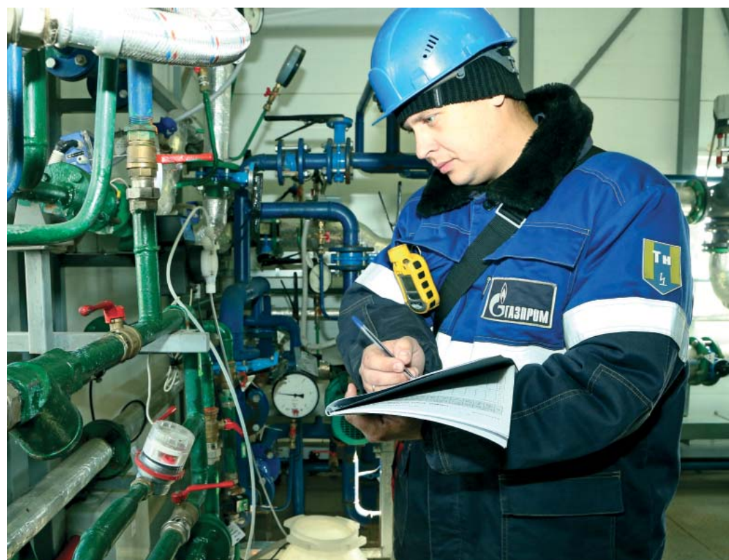
Александр Михайлов проверяет параметры работы котельной
