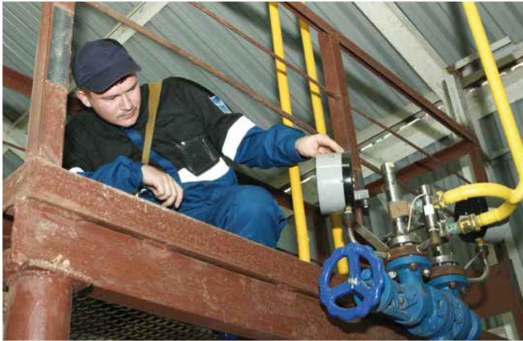
Ведется проверка оборудования
