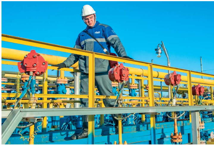
Оператор по добыче нефти и газа установки комплексной подготовки газа № 12 Денис Слободсков контролирует давление шлейфа скважин на блоке входных ниток
