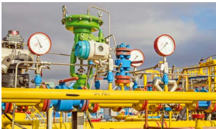
Установка комплексной подготовки газа № 1
