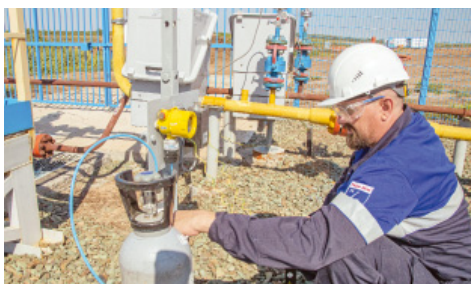
Мониторинг фонда скважин повышает эффективность их эксплуатации
