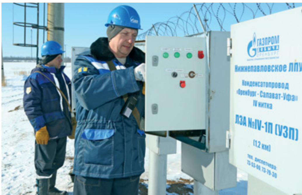
Электромонтер Олег Шукин осматривает внутренние схемы щитов управления запорной арматурой
