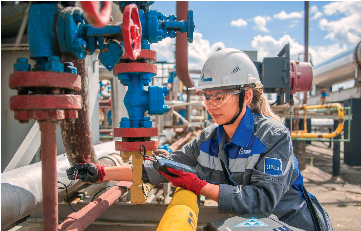
Марина Багаева проводит диагностику трубопровода на установке комплексной подготовки газа № 10
