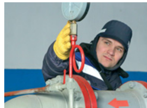
Оператор товарный Дмитрий Дмитриев контролирует работу насосного оборудования
