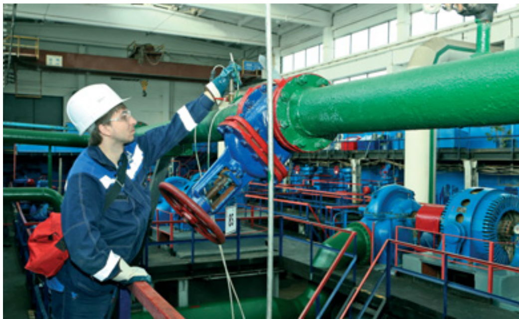
Оператор дистанционного пульта управления Сергей Бахнин контролирует герметичность оборудования подачи реагента
