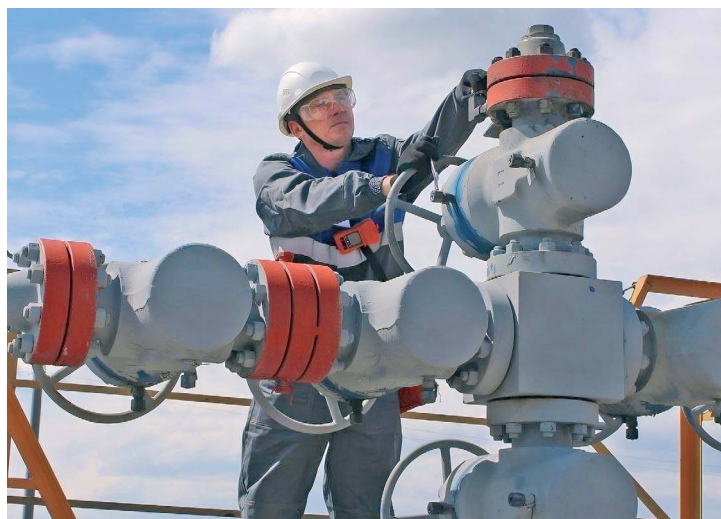
Оператор по исследованию скважин ГПУ Андрей Симанов устанавливает технический манометр
