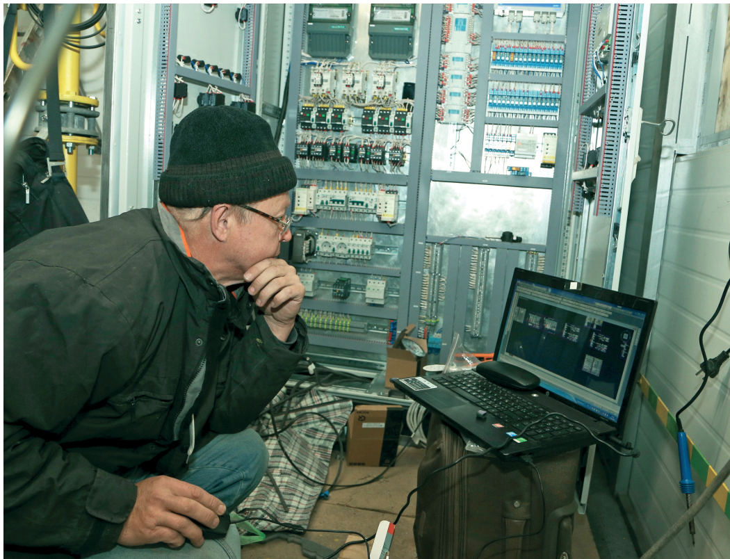
Инженер-наладчик Сергей Сиротин выполняет настройку оборудования
