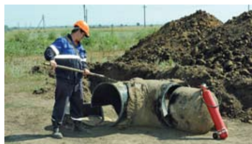
Использование данной конструкции тройников теперь недопустимо
