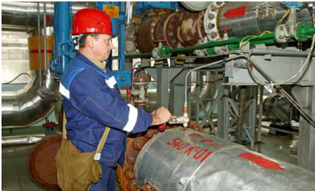
Установка У-26 остановлена на ремонт
