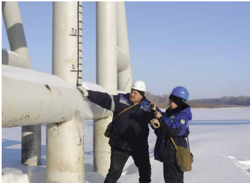
Андрей Шумилин и Юлия Ефашкина обследуют опоры воздушного перехода. На одной из них — шкала для определения уровня подъема воды во время паводка
