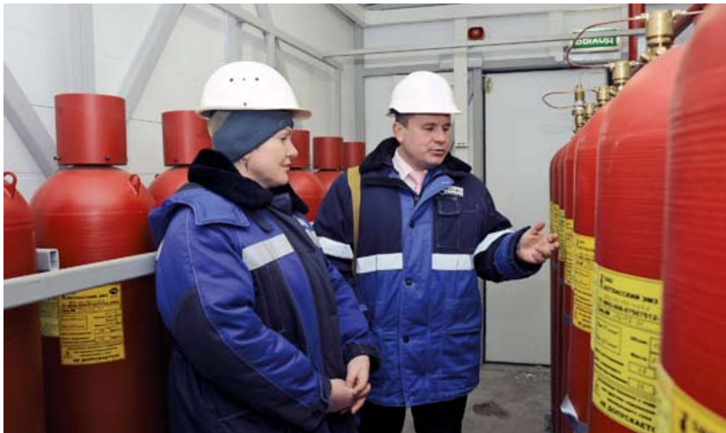
Так выглядит новая установка пожаротушения изнутри
