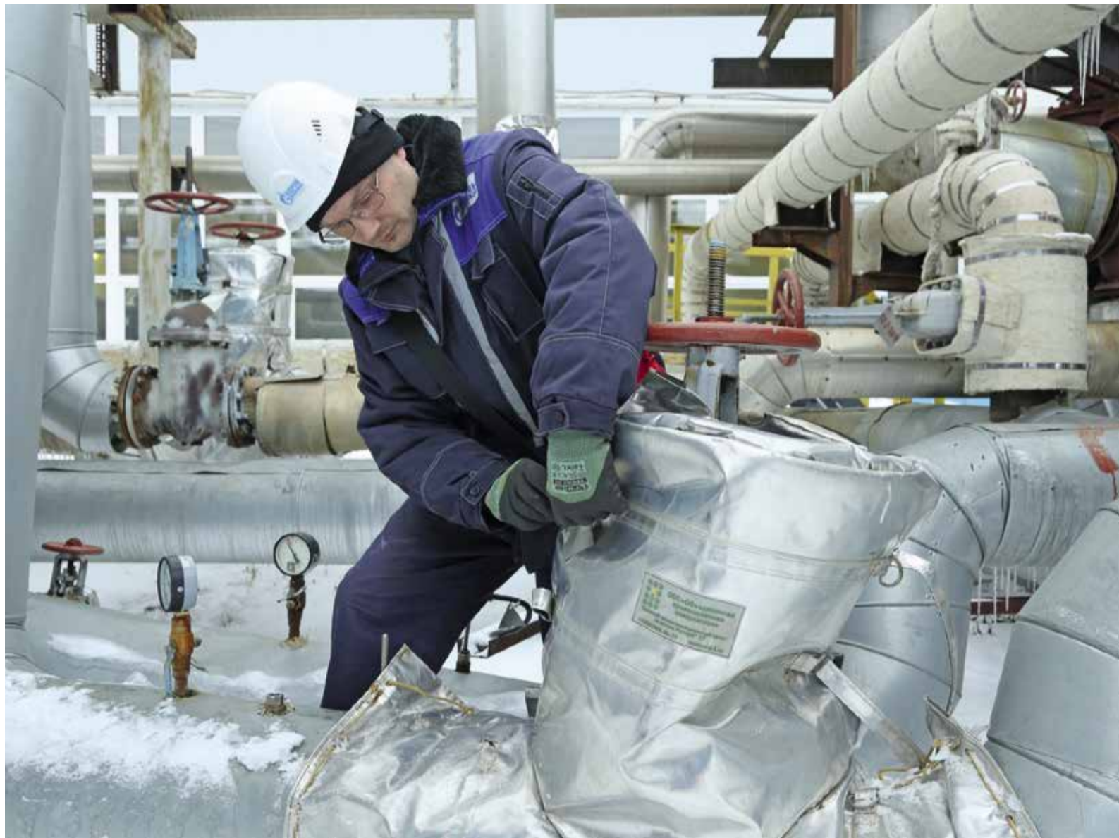
Машинист насосных установок Алексей Пушенко надевает быстросъемную тепловую изоляцию на запорную арматуру
