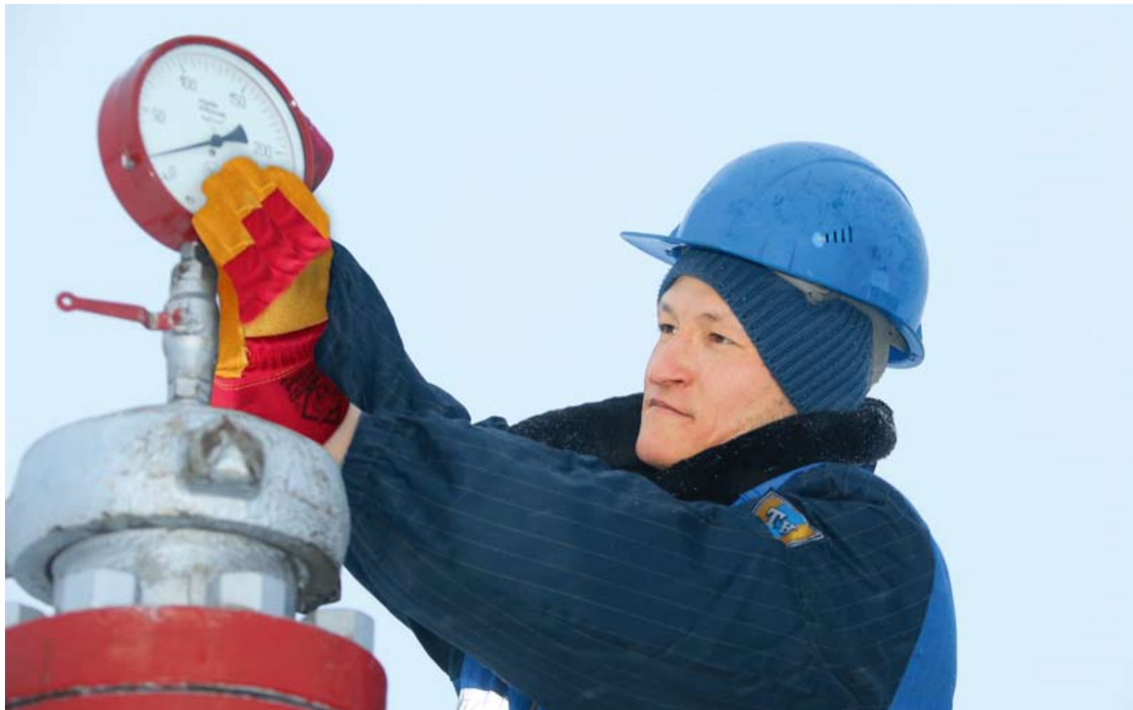
Ведется контроль давления на устье скважины
