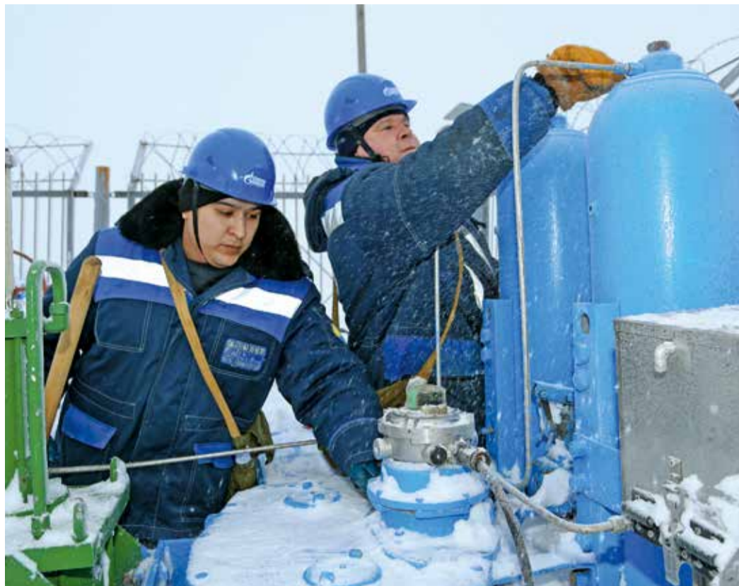
Трубопроводчики линейные Тимур Гайсин (слева) и Виктор Ванчинов очищают от снега и осматривают оборудование
