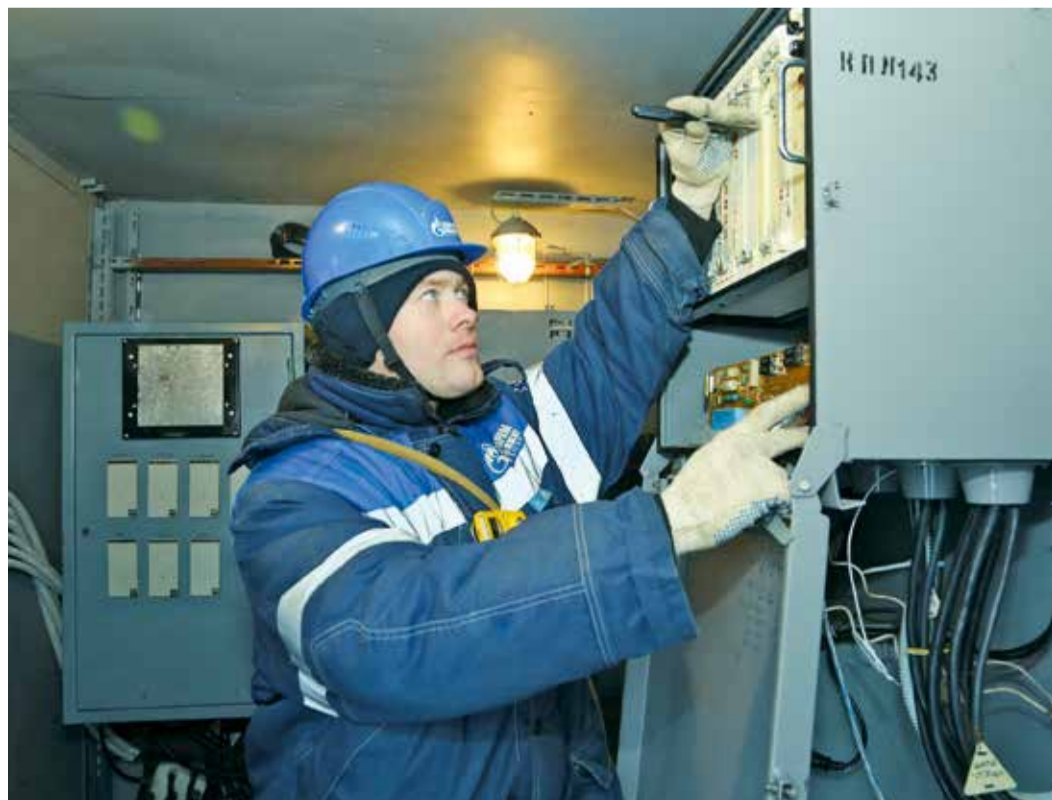
Слесарь КИПиА Кирилл Марков проводит обслуживание телемеханики
