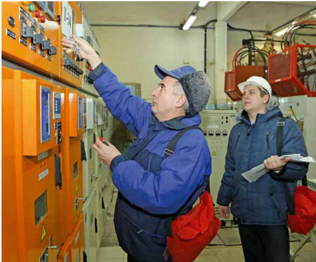
Петр Барышев (слева) и Дмитрий Лысиков ведут осмотр технических устройств распределительного пункта
