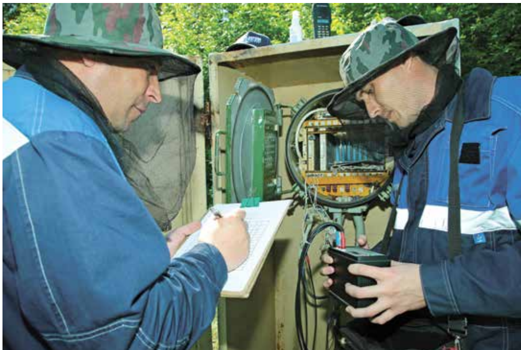
Электромонтер Виктор Страхов и электромеханик Роман Дубский проводят измерения кабеля по постоянному току
