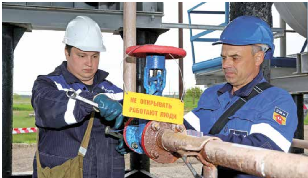
Операторы Роман Штрамель (слева) и Олег Сорокин ведут монтаж проглушек для вывода емкости в ремонт
