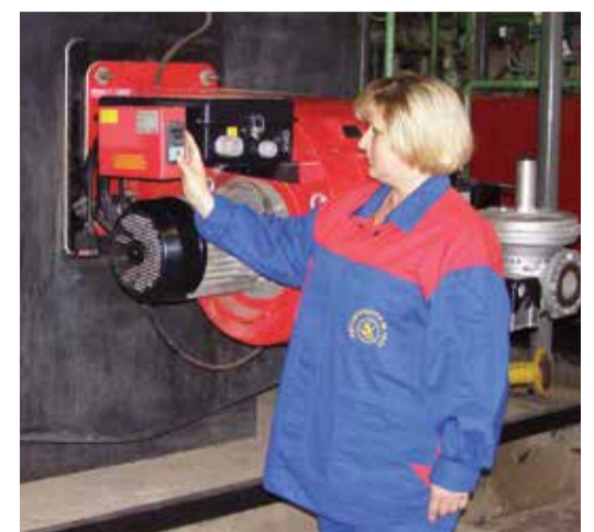
Ведется проверка работы водогрейного котла
