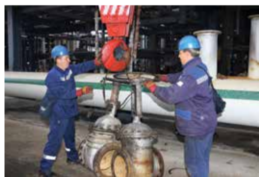
Акцент на запорную арматуру
