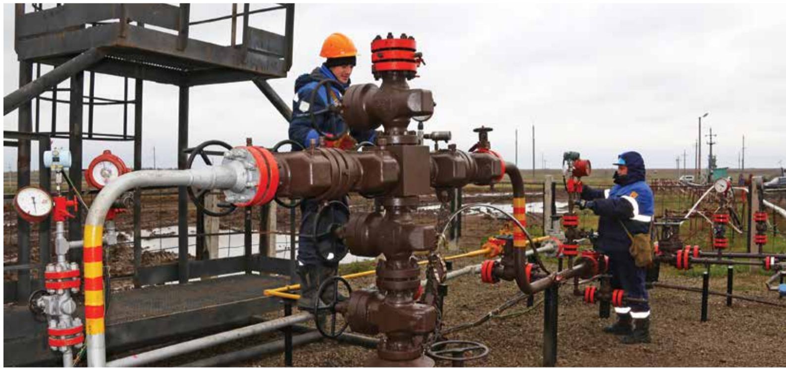
На скважине № 558-н добыча нефти ведется с помощью погружного электронасоса
