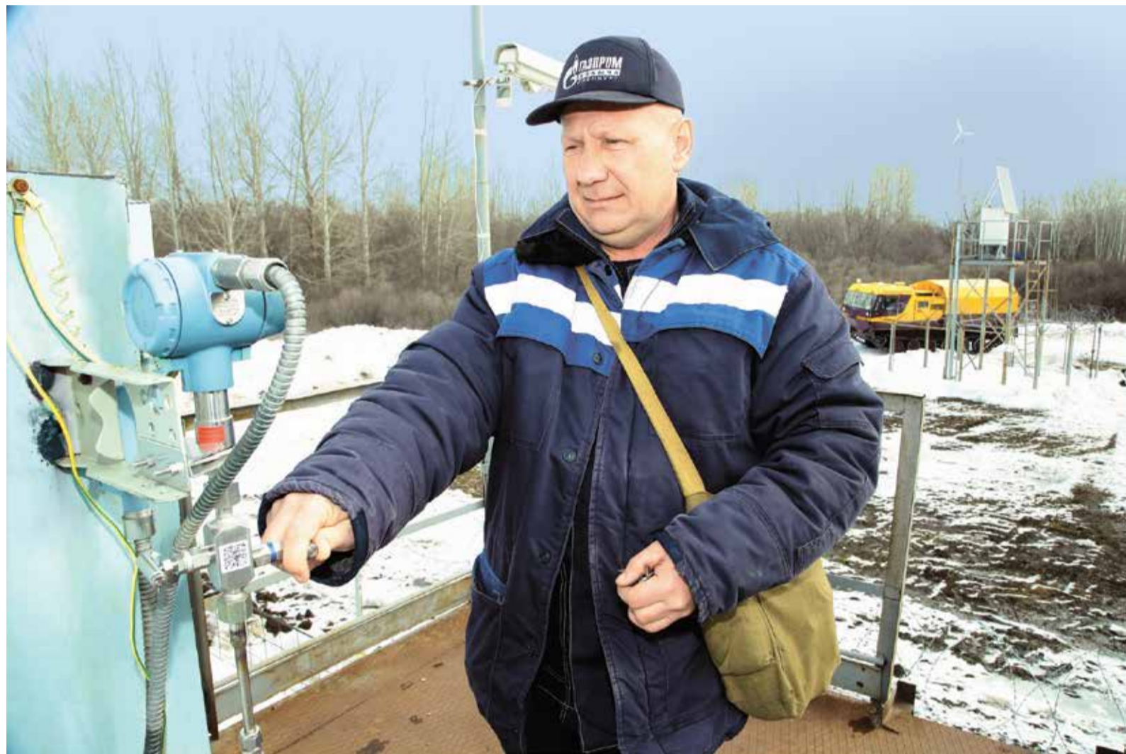
Оператор по добыче нефти и газа Валерий Чернышов проверяет давление в гидросистеме управления клапанами-отсекателями. Скважина № 15016 оборудована системой видеонаблюдения, а также автономной системой электропитания (видна на заднем плане снимка)
