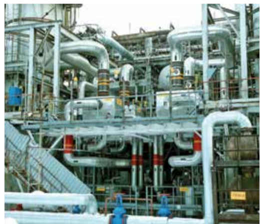
На установке У-370 смонтированы новые теплообменники
