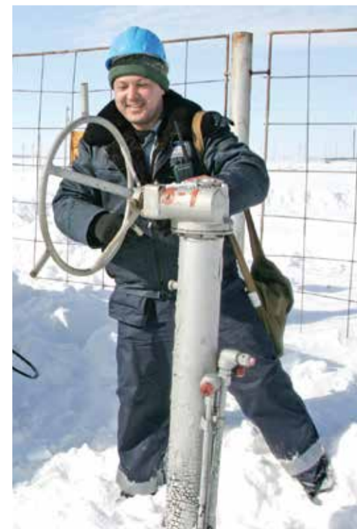
Обслуживание объекта ведет Юрий Бердников
