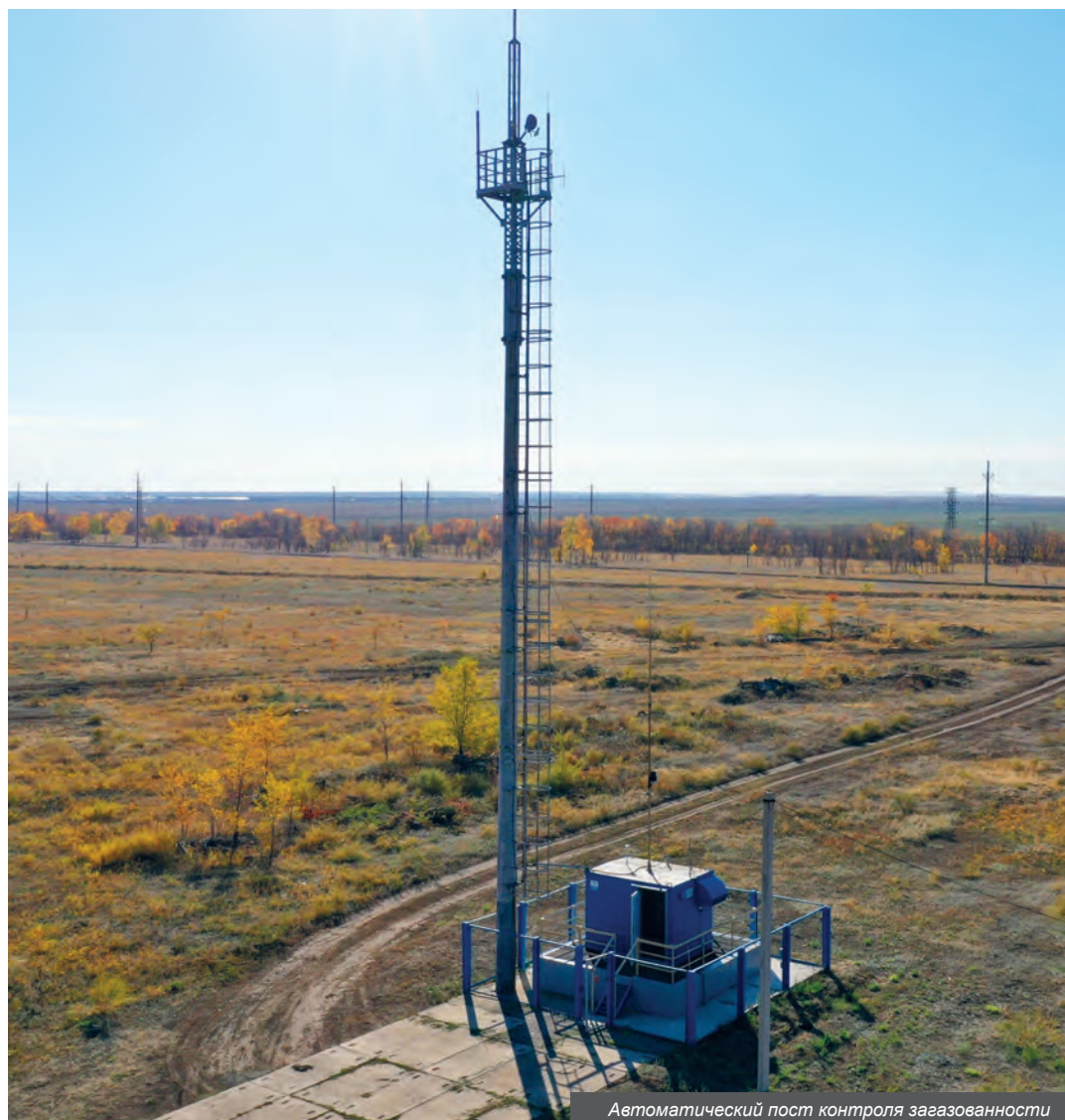
Автоматический пост контроля загазованности
