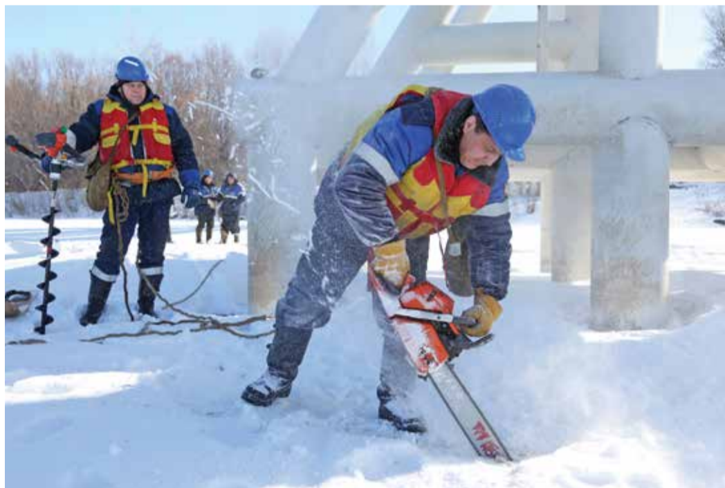
Трубопроводчики линейные Виктор Ванчинов (слева) и Юрий Бердников ведут распил льда вокруг опор
