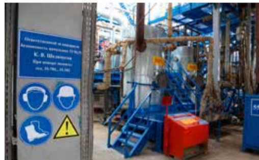
Установка 3У-50155 газоперерабатывающего завода
