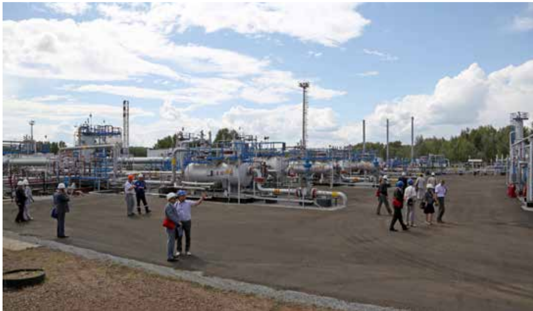
Установка комплексной подготовки газа № 15 газопромыслового управления
