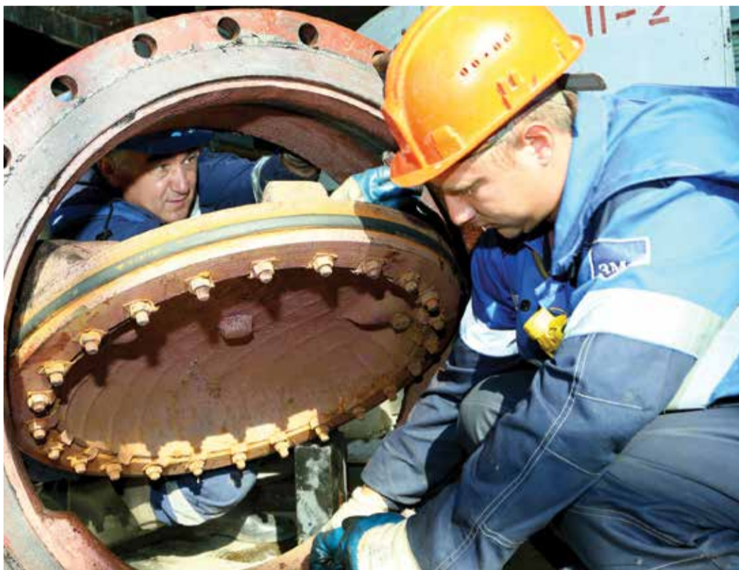
Ежегодный планово-предупредительный ремонт обеспечит надежность работы оборудования
