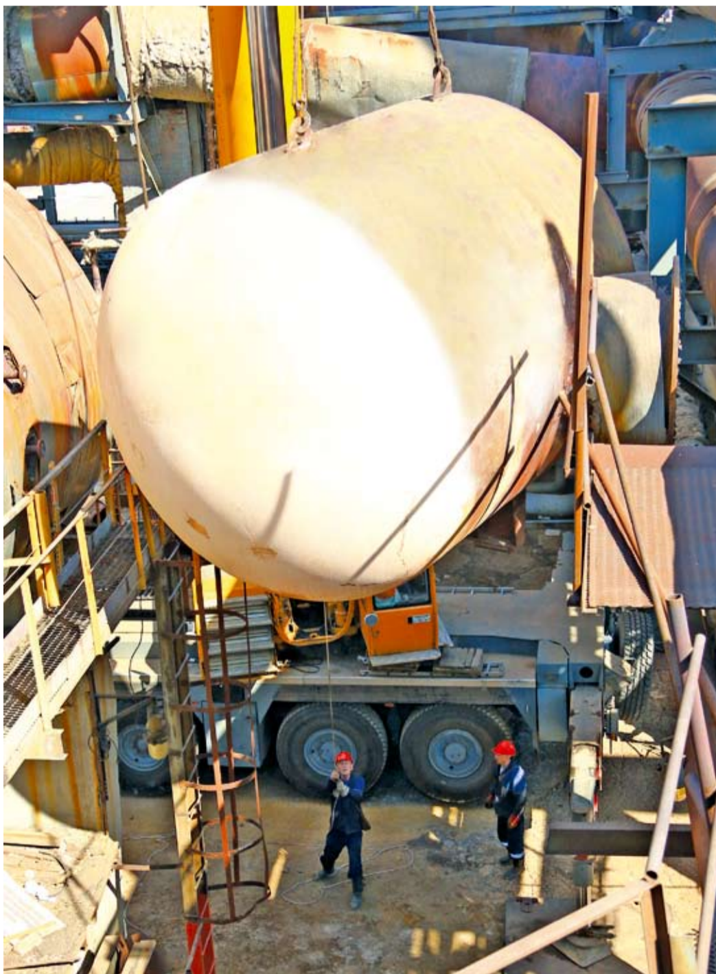
Входную распределительную камеру весом около 6 тонн Liebherr поднял как пушинку. Грузоподъемные работы требуют от ремонтников ювелирной точности. Малейшее отклонение от траектории может привести к повреждению оборудования и эстакад установки
