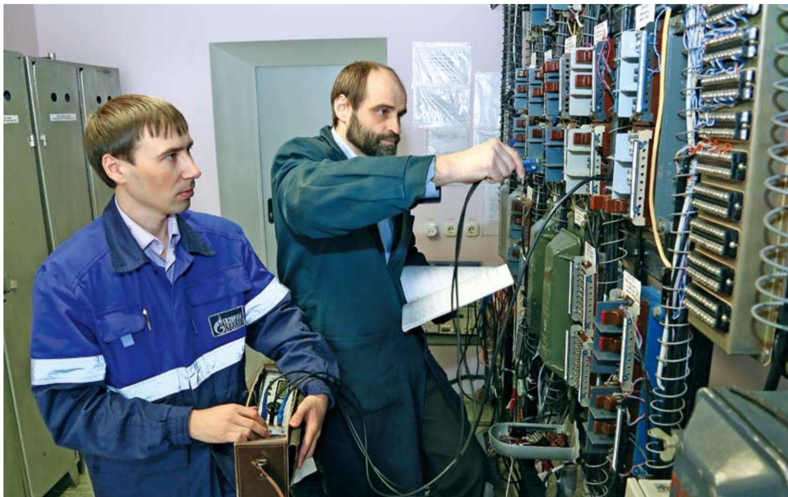
Контроль электрических параметров кабеля на узле связи газоперерабатывающего завода
