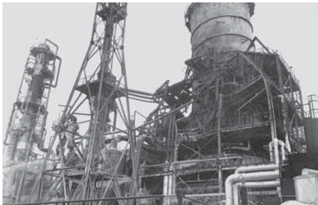
Гелиевый завод после аварии. 1987 год
