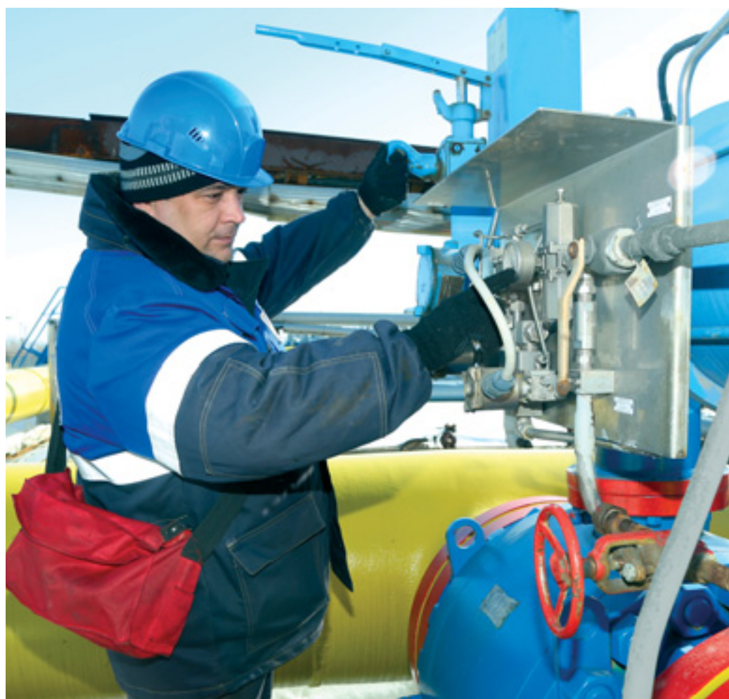
Оператор технологических установок Владимир Сурков производит осмотр запорно-регулирующей арматуры перед пуском сепаратора
