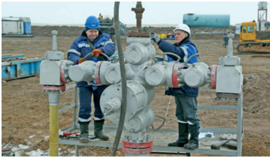
Оператор по добыче нефти, газа и конденсата Владимир Мерзлик (слева) и мастер по добыче нефти, газа и конденсата Василий Хорьяков готовят фонтанную арматуру к демонтажу
