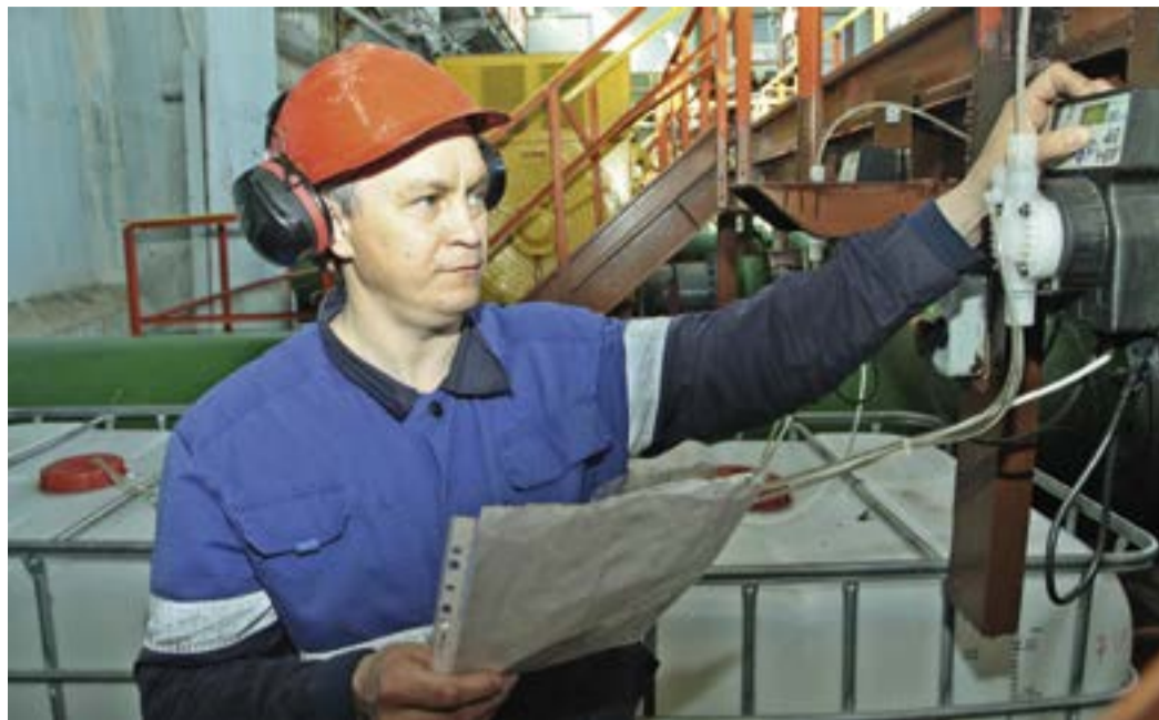
Слесарь-ремонтник Алексей Карпенко настраивает работу насоса-дозатора химреагента
