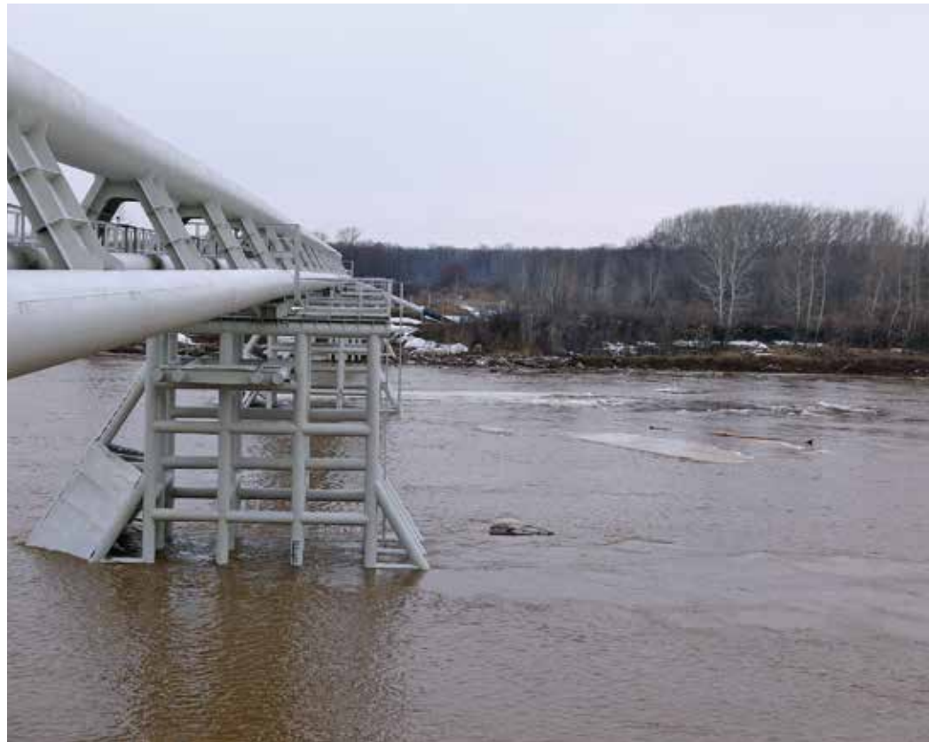
В период паводка опоры воздушных переходов трубопроводов через реки наиболее уязвимы
