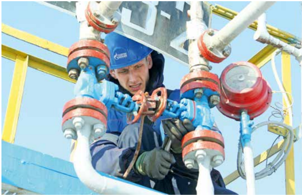
Оператор по добыче нефти и газа Дмитрий Яковлев проводит технический осмотр запорной арматуры
