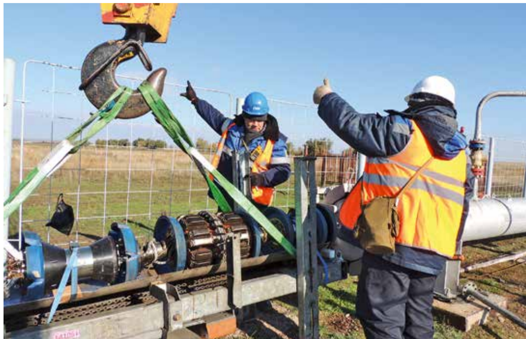
Трубопроводчики линейные Сергей Татаринов (слева) и Сергей Ким готовятся к «отправке» дефектоскопа по трубе
